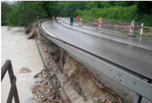
Abb. 5-4: Uferschaden an der B 305
