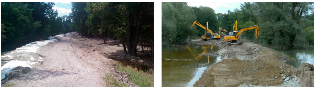
Abb. 4-4: Deichbruch Isar, Bruchstelle und Schadensbeseitigung nach dem Hochwasser 2013
